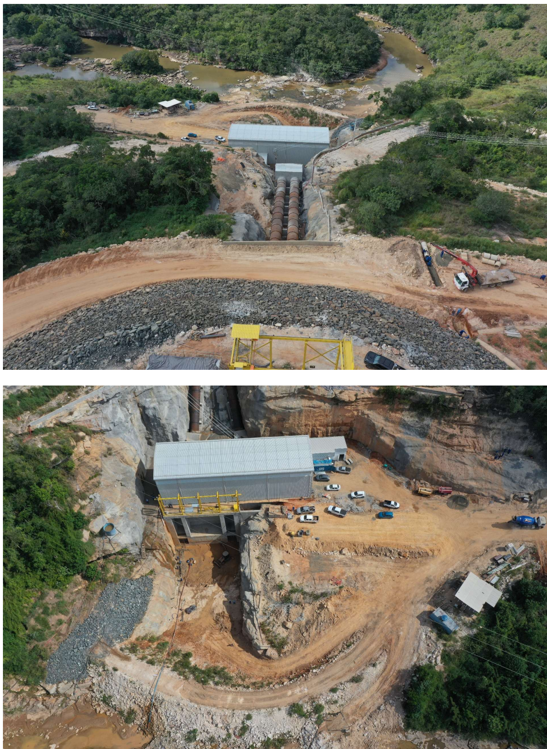
Figura 10 – Conduto forçado e casa de força principal
