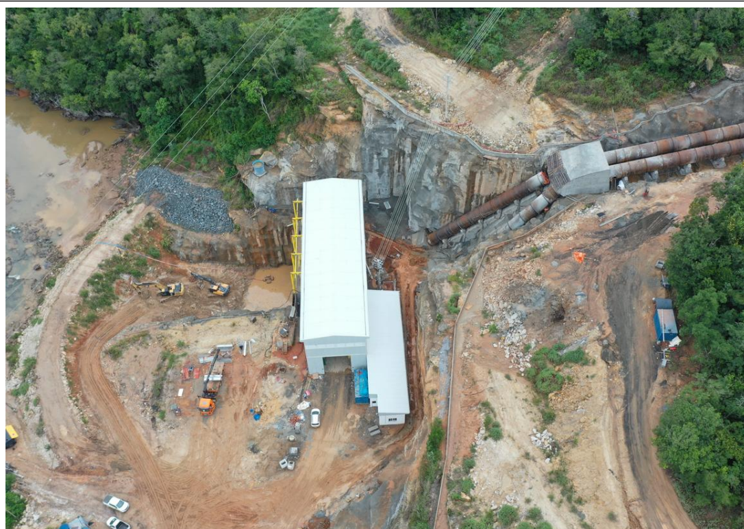
Figura 12: Casa de Força Drone, em 10/04/2026. G5 Engenharia
