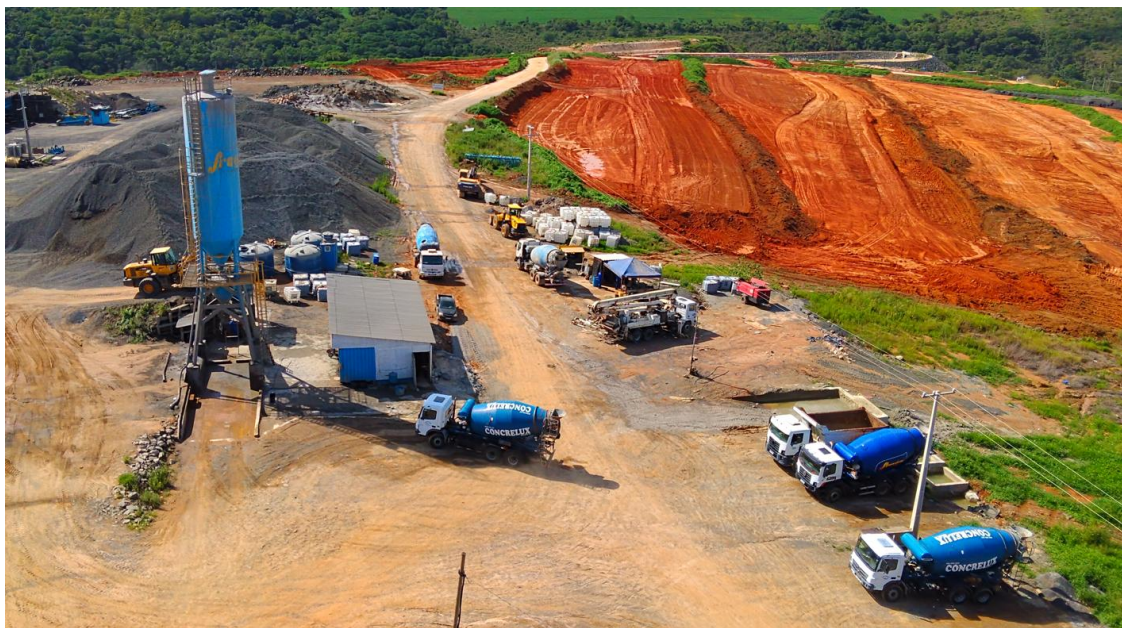
Figura 11: Central de Concreto. À direita, rampa de lavagem dos caminhões betoneiras. Ao alto, à direita, jazida de argila explorada para compor o coração do barramento. Ao meio desta, as linhas de solos férteis reservados. Drone, em 15.12.2025, Engenharia.
