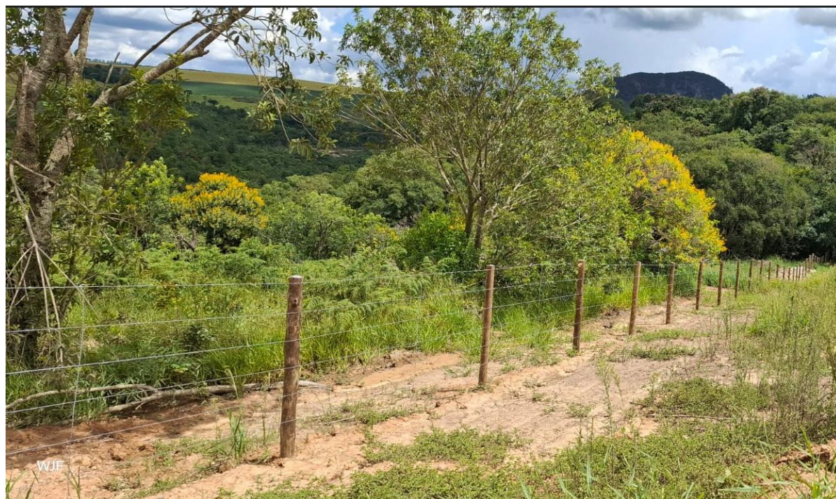
Figura 19: Trabalhos de execução da cerca na margem esquerda. Fonte G5 Foto em 13/02/2026
