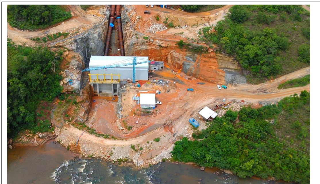
Figura 17: O canal de fuga será completado no período de enchimento do Reservatório Drone em 12/02/2026. G5 Engenharia
