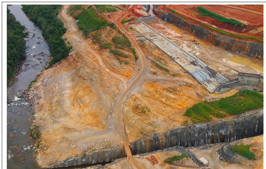
Figura 14: Bota-espera removidos do setor onde se instalará o vertedouro. Drone, em 12/02/2026. G5 Engenharia
