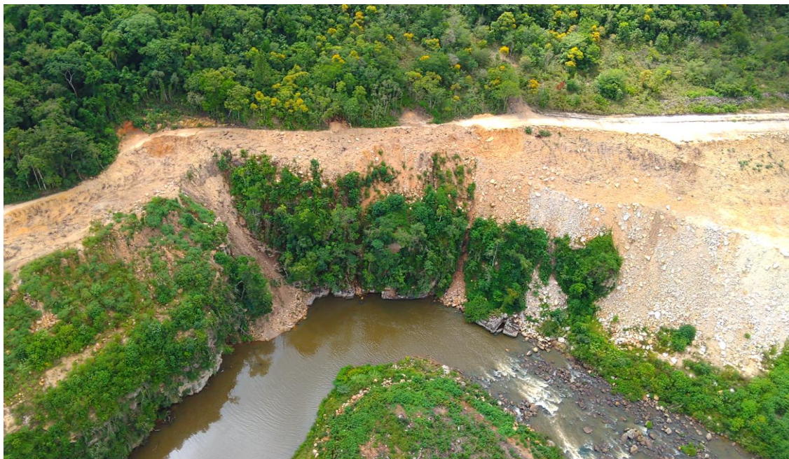
Fig. 02: A supressão da vegetação das encostas rochosas propicia riscos de acidentes. Drone em 12/02/2026 fonte: G5 Engenharia
