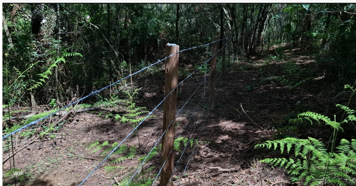
Figura 20: Trabalhos de execução da cerca na margem esquerda. Fonte G5 Foto em 13/02/2026
