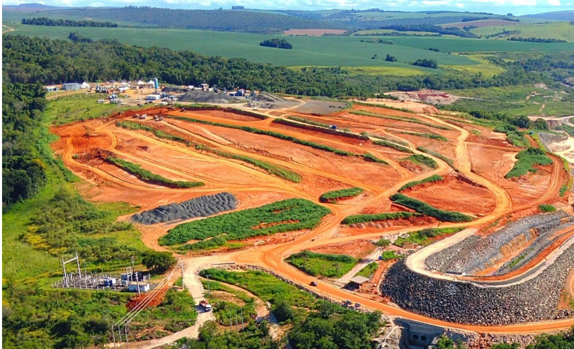
Figura 11: Jazida de argila explorada para compor o coração do barramento, com as linhas de solos férteis reservados. Drone, em 12.01.2026, Engenharia.
